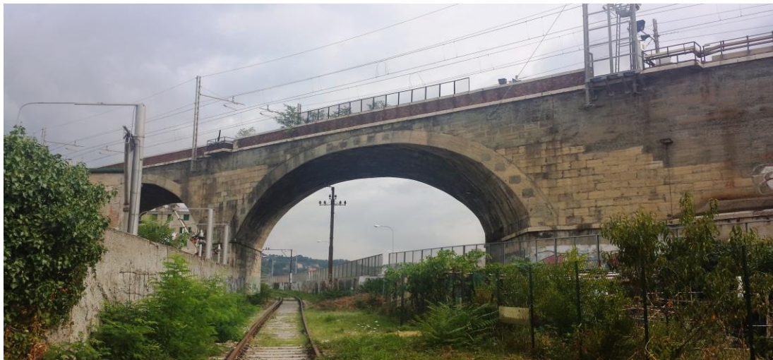
Tratto iniziale del binario all'incrocio tra Via Ferri e Via Sant'Ambrogio di Fegino
